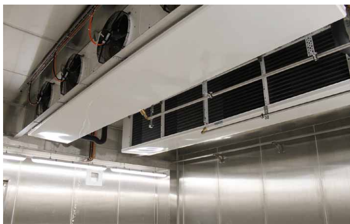
Anlagen auf dem neusten Stand der Technik – Kälte 3000 AG.
